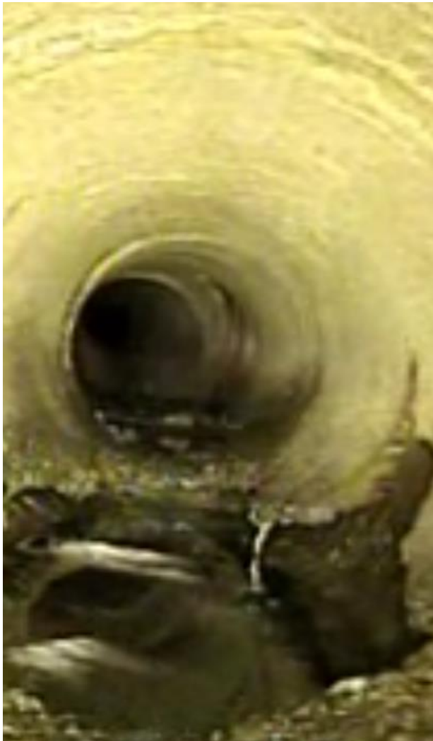
Exemple de la condition des égouts du quartier Saint-Louis
