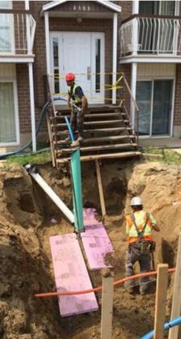
Branchement de service sous une galerie
